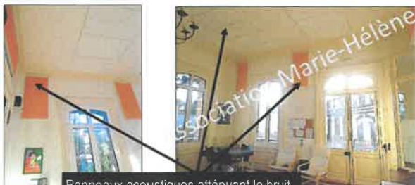
Panneaux acoustiques atténuant le bruit
